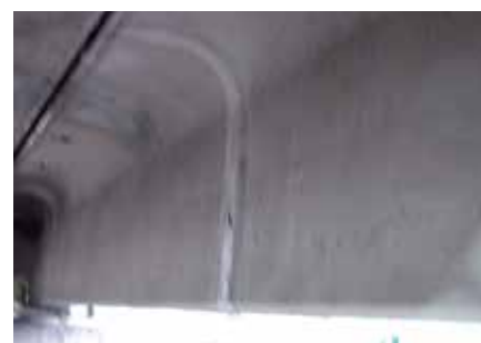
Рис. 3. Вертикальная трещина в стенке железобетонной балки
