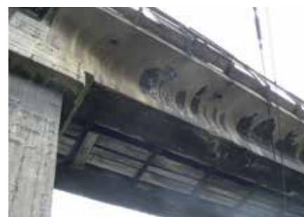
Рис. 4. Трещина в вуте пролетного строения из предварительно напряженного железобетона
