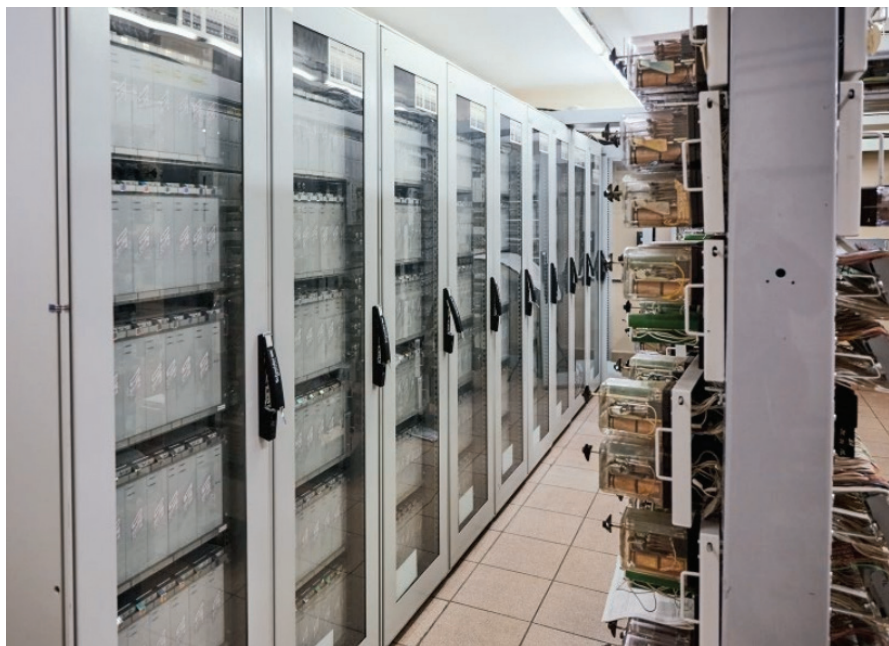
Рис. 2. Шкафы системы БМЦ-М рядом с релейными стивами существующей системы электрической централизации на станции «Митино» во время опытной эксплуатации
