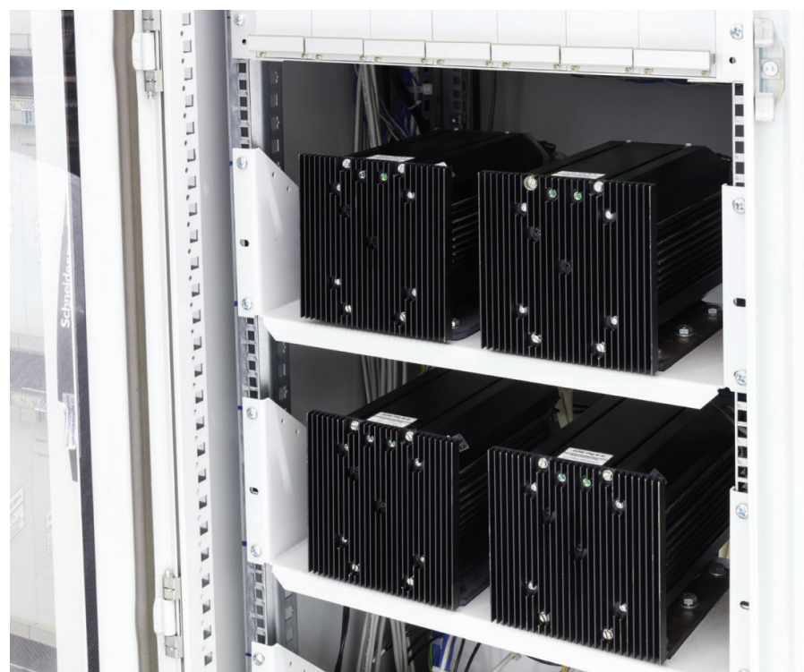
Рис. 5. Основной и резервный комплекты модуля централизации и блокировки
