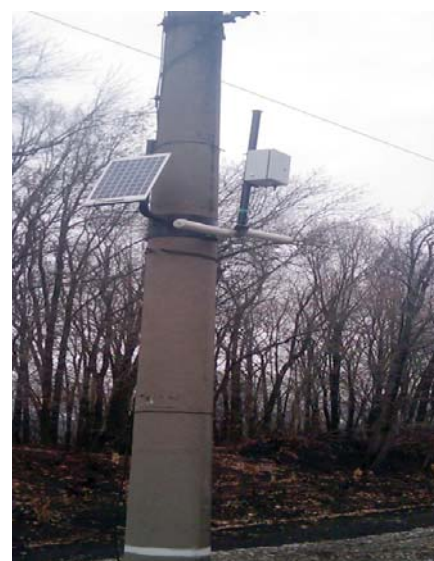
Рис. 2. Базовая станция с антенной и солнечной батареей
